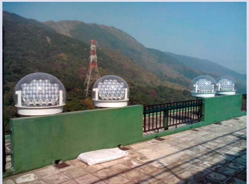
四組光線追蹤太陽能照明系統已安裝在保育大樓的屋頂，將陽光導入教育部辦公室。
